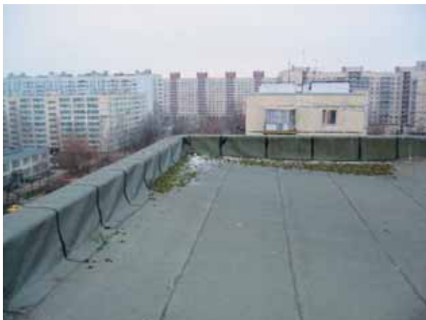
Фото 37 Образование воздушных полостей и складок на примыкании к вертикальной поверхности
