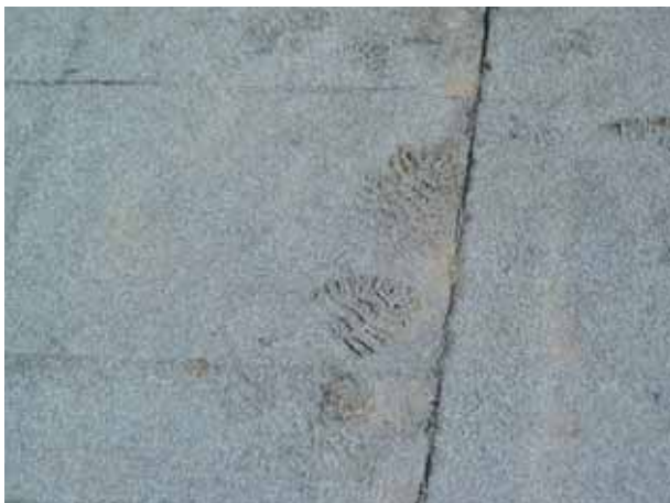
Фото 27 Следы на поверхности кровельного ковра
