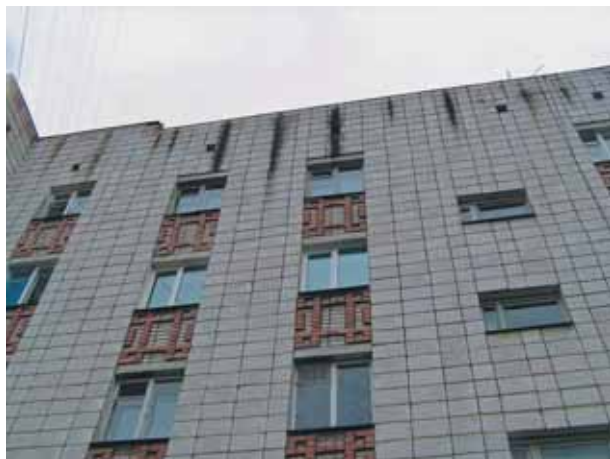
Фото 44 Следы протечек на фасаде по парапетному покрытию
