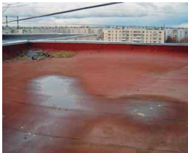
Фото 2 Зона застоя воды на кровле
