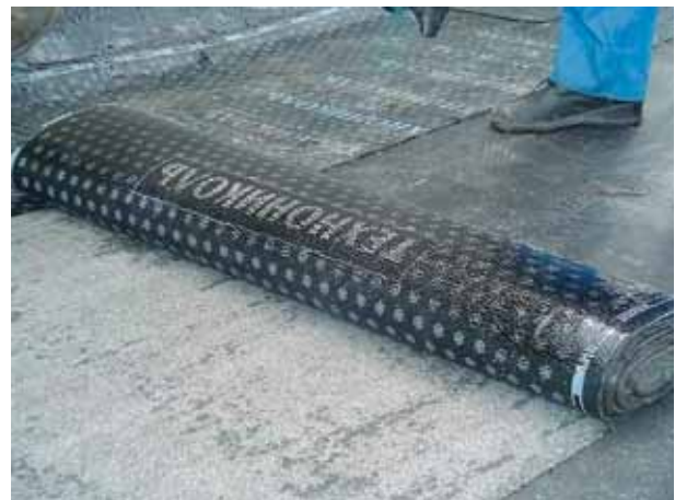
Фото 28 Деформация рулона кровельного материала из-за неправильного хранения
